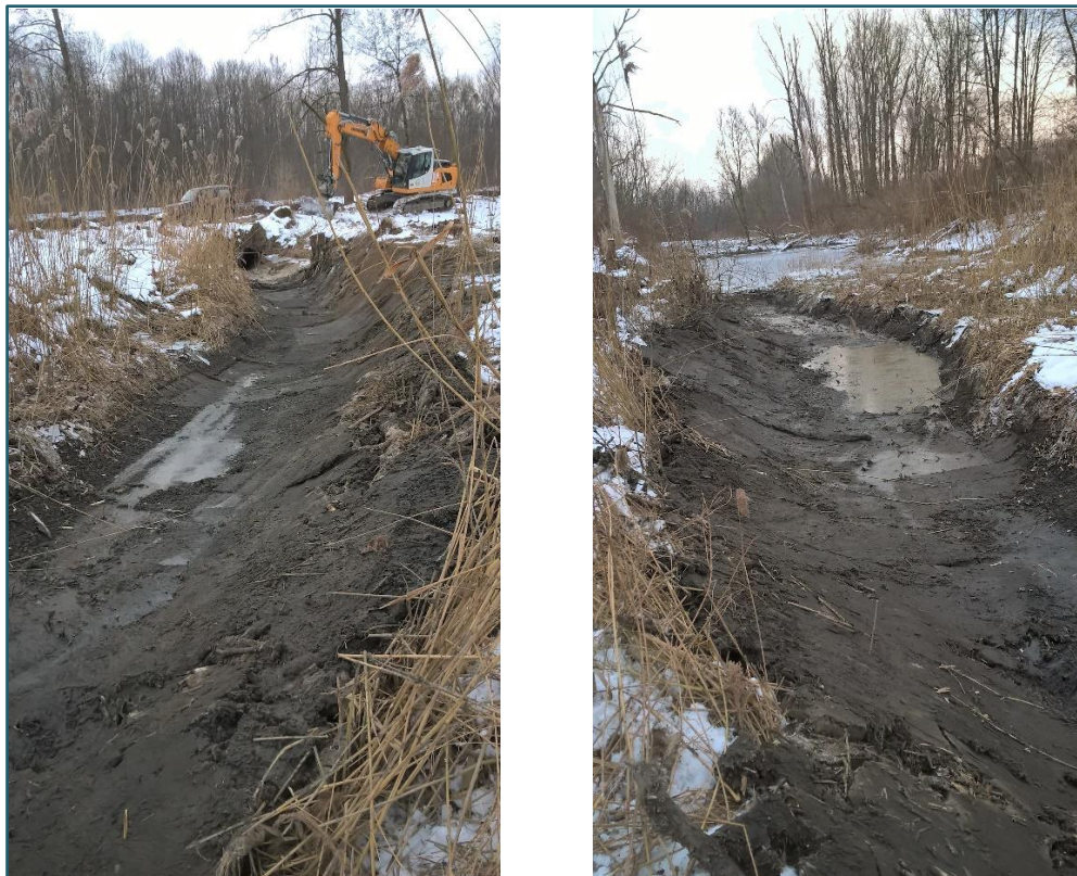
Abb. 8: Beide Bilder zeigen den sanierten Zulauf bei abgesenktem Stauziel. Das linke Bild dokumentiert den Verlauf bis zur bestehenden Rohranbindung. Im rechten Bild ist im Hintergrund das Altwasser „Nasenhaken“ zu erkennen, das zum Zeitpunkt der Aufnahme noch über einen Erdwall vom sanierten Zulauf abgetrennt war.
