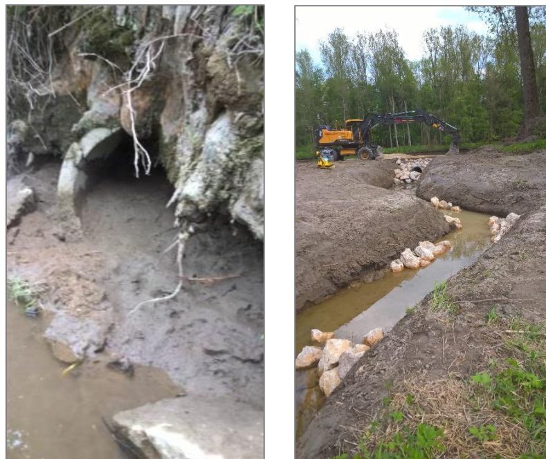
Abb. 8: Der Vergleich der Ausgangssituation (Bild links) mit der neuen Anbindung (Bild rechts) macht den Unterschied sehr deutlich
