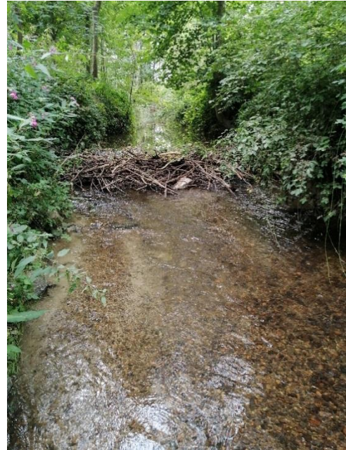
Abb. 11: Biberdamm als Querbauwerk im Flutgraben
